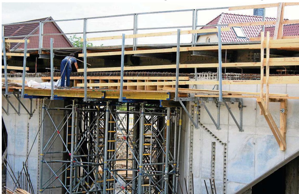
Derzeit werden Stahlbetonarbeiten an der neuen Eisenbahnüberführung im Bereich der Hinterstraße ausgeführt.
