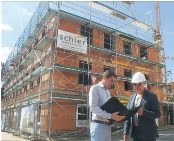
KWG-Projektleiter Marc Thoma (l.) und Architekt Ronald Wascher beim Baustellen-Rundgang. Im vorderen Bereich ist das Gebäude bereits bis zum zweiten Obergeschoss „hochgezogen“.
